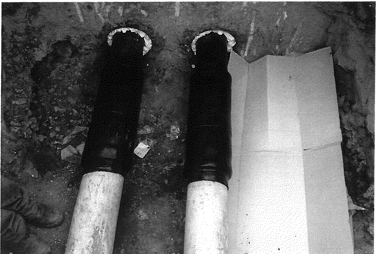
Szigetelt, zsugorcsővel lezárt vezeték
